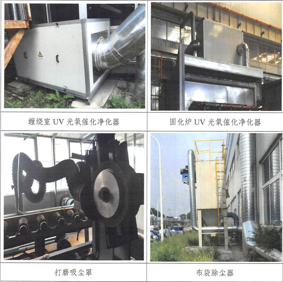
图 4-2 废气处理设施现场图
